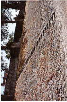
Plusieurs escaliers sont aménagés dans le perré (source : Région Centre – Inventaire régional)
