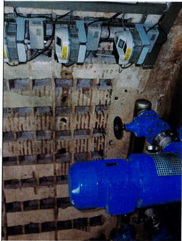
Pompage de surpression
