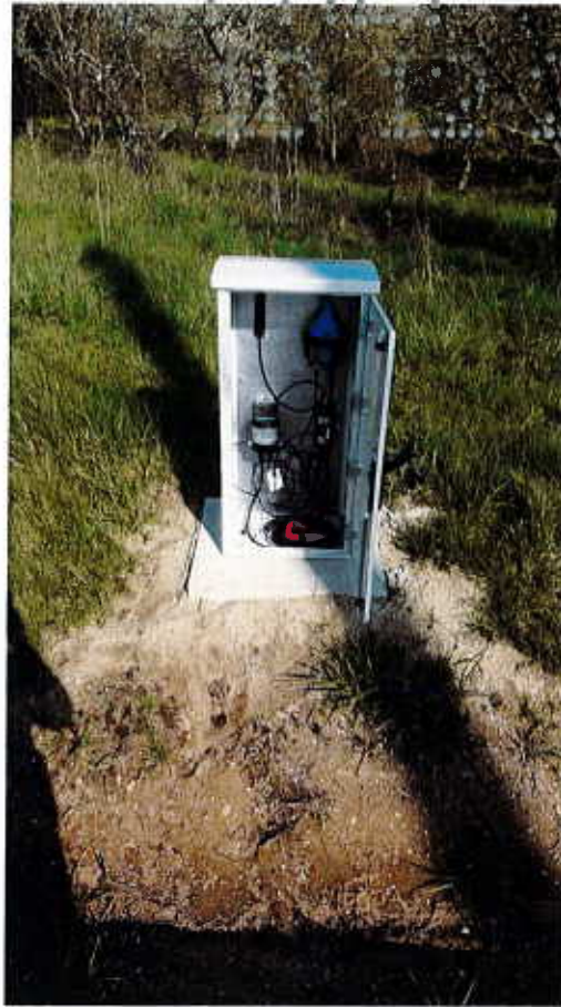
Débitmètre Q1 –Secto 1 - Route de Rougeou (RD119) – Lieudit « La Taille du Chêne » Vue du coffret de report d'information + télétransmission
