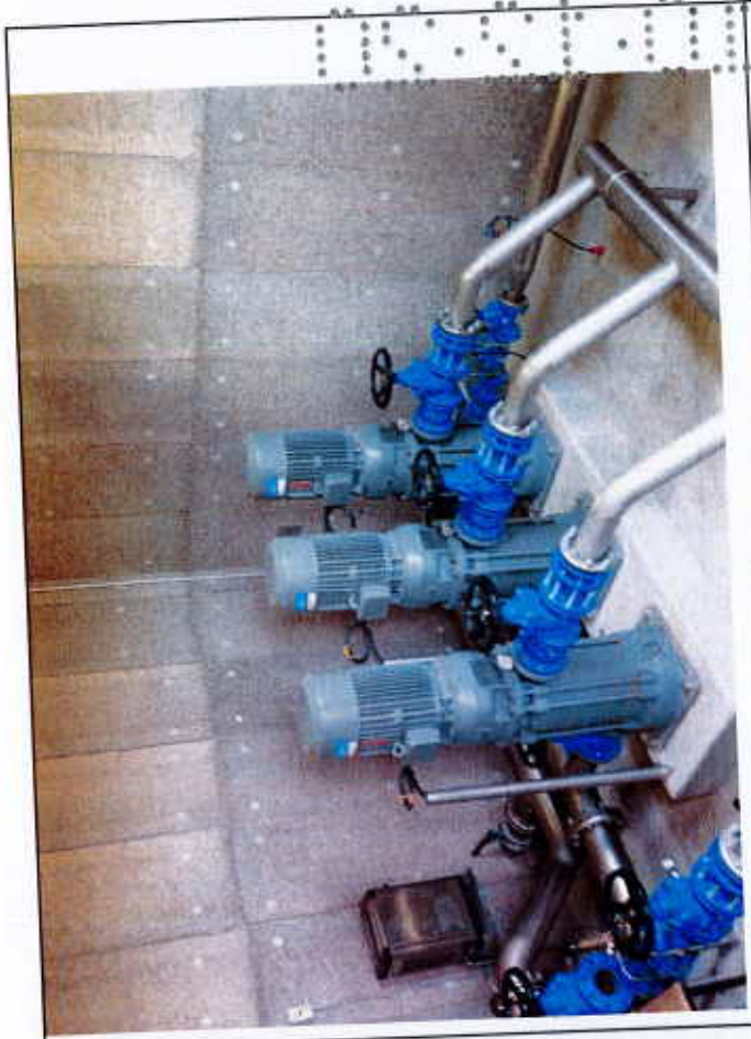
Pompage de reprise
