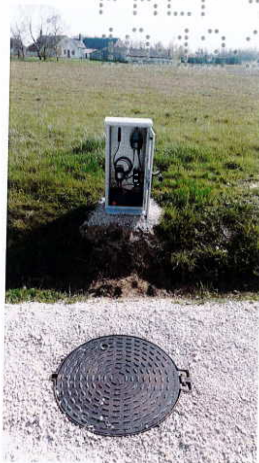
Débitmètre Q2 –Secto 2 – Route de Fleury – Lieudit « Les Varennes » Vue du coffret de report d'information + télétransmission
