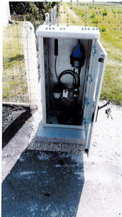
Débitmètre Q3 –Secto 3 – Rue de Contres Vue du coffret de report d'information + télétransmission
