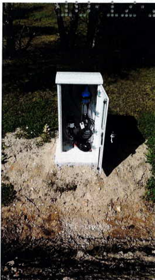
Débitmètre Q6 –Secto 6 – Rue de Murs de Sologne Vue du coffret de report d'information + télétransmission
