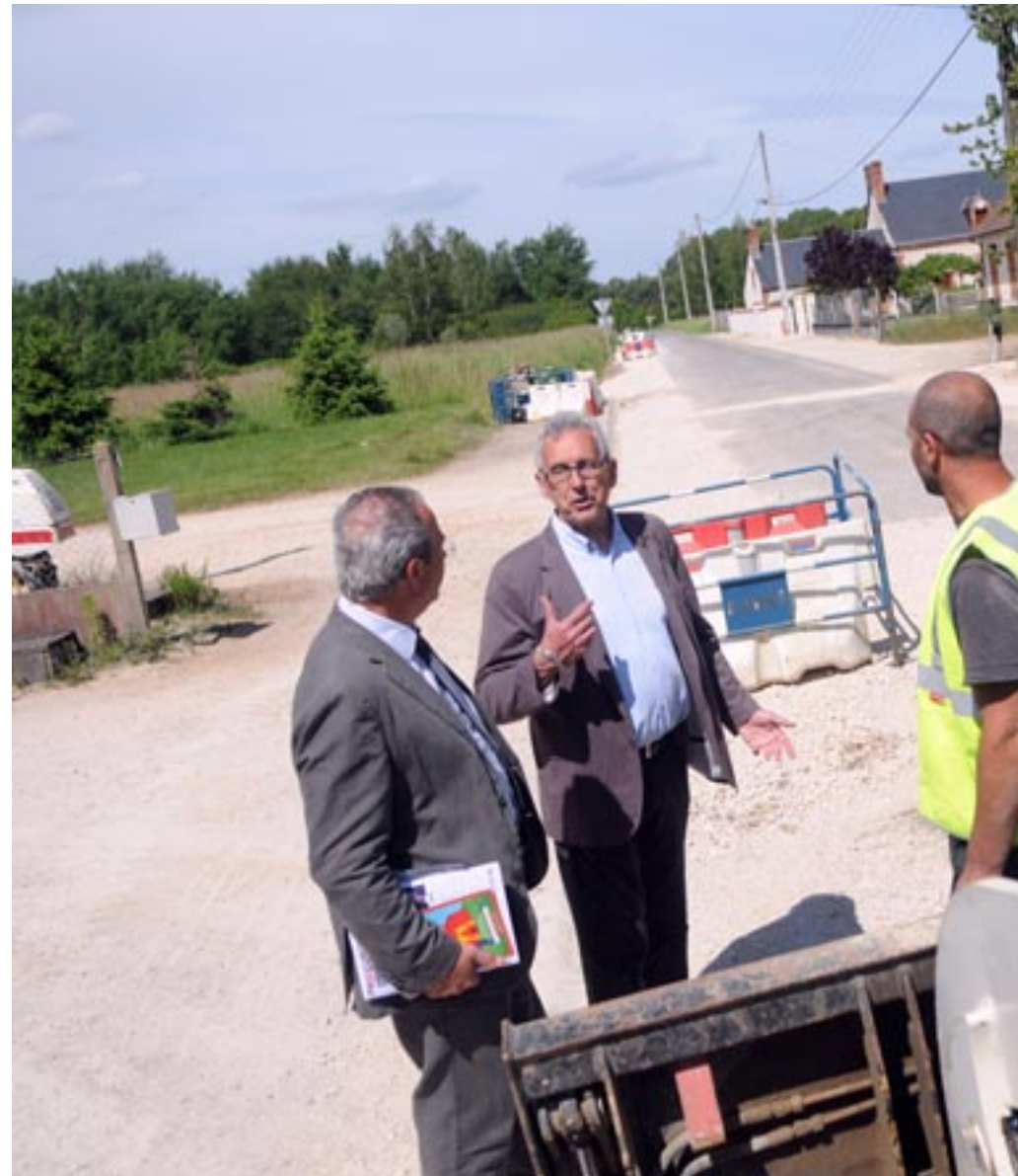
L'entrée dans Grand Chambord a permis de résoudre l'urgence environnementale provoquée par l'effondrement de la route.
