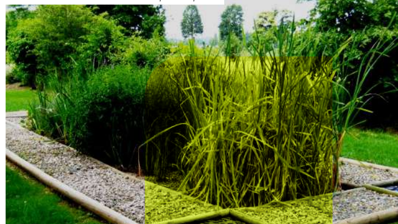
Traitement assainissement non collectif par filtre planté.
